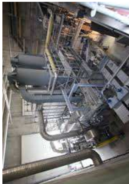
Station d'épuration de La Feyssine (Villeurbanne)
